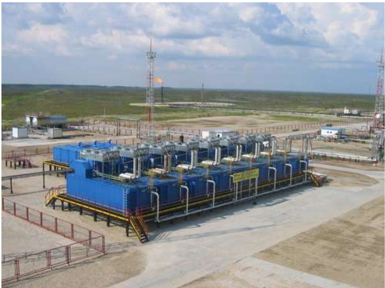
Блок 9 МВт (7,7 Гкал)
